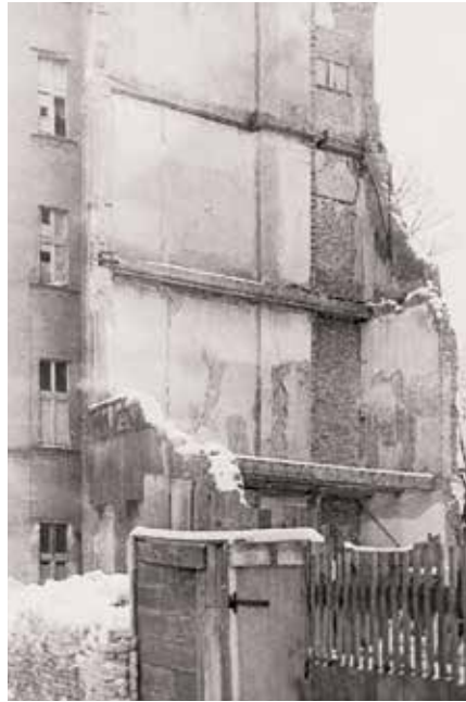
Die Abrisskante des Seitenflügels der Wilhelmstraße 3
